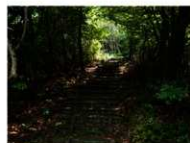
④散策路の階段。老朽化している。
