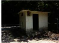
④公衆トイレ。経年劣化している。
