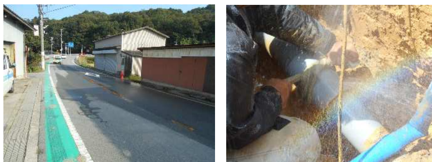
－老朽化した塩化ビニル管の漏水－
