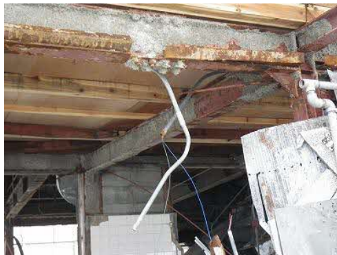
建物に残存した吹付け材
