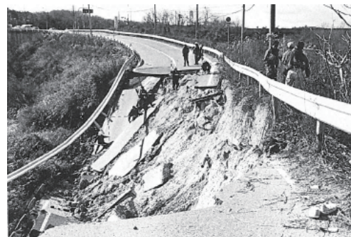
▲地震で崩落した道路（市内）
