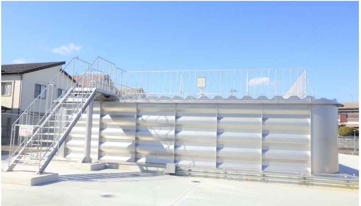
自由が丘配水池
