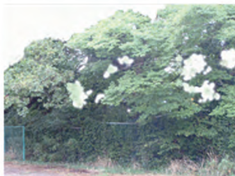
二の丸跡法面の樹木の繁茂状況
