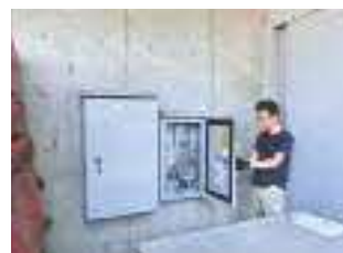
[④発電機接続口]
