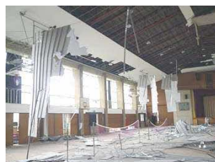
[①東日本大震災における天井落下]
